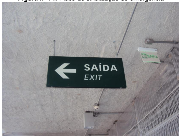
Figura nº 14: Placa de sinalização de emergência
