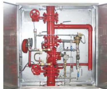
Gabinete completo com Válvula de Dilúvio e Proporcional em linha
